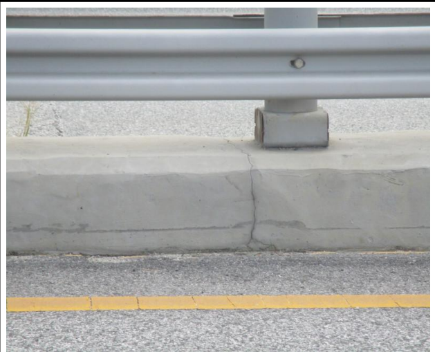
【중분대 연석 균열/건조수축, 재질열화】
