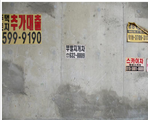
【교대 망상균열/온도변화, 건조수축】
