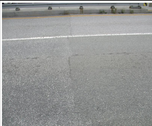
【접속부 포장 균열/차륜하중 반복】
